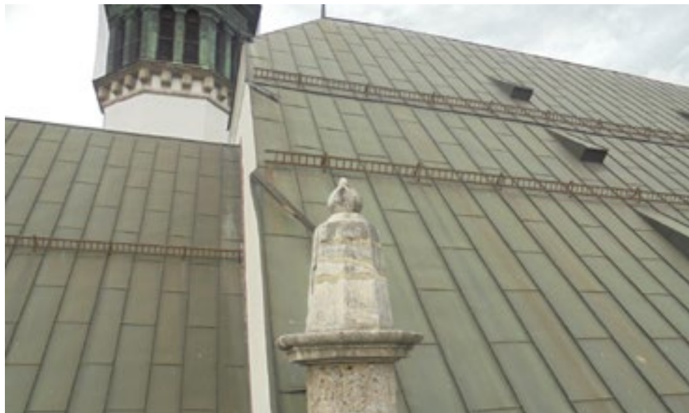
Das Kupferblech des Hofkirchendaches musste nach einem Föhnsturm repariert werden.
