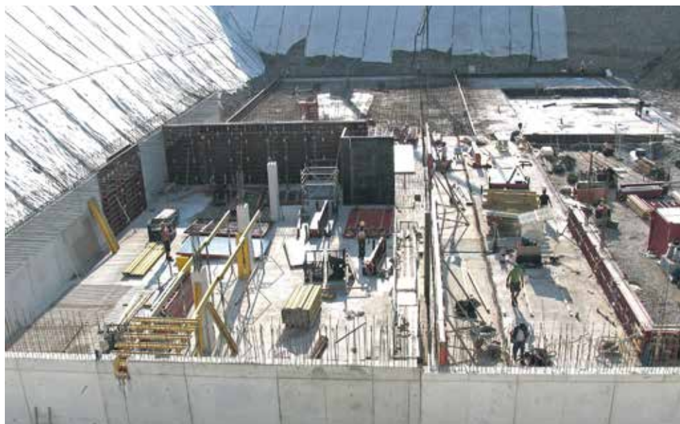
Abb. 1: Sammlungs- und Forschungszentrum. Blick von Westen in das im Bau befindliche Depot der Archäologie im Untergeschoss -2 am 21. Juli.
