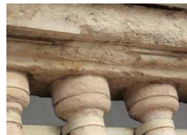
Schadhafte Antragung bei der Dachbalustrade. Foto: Erich Reichl
