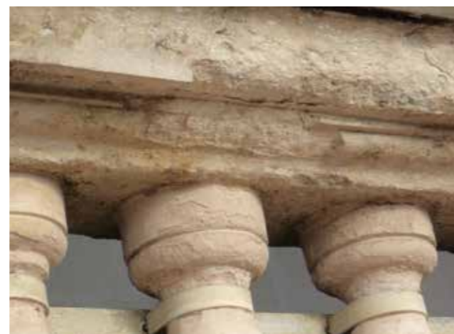
Schadhafte Antragung bei der Dachbalustrade. Foto: Erich Reichl
